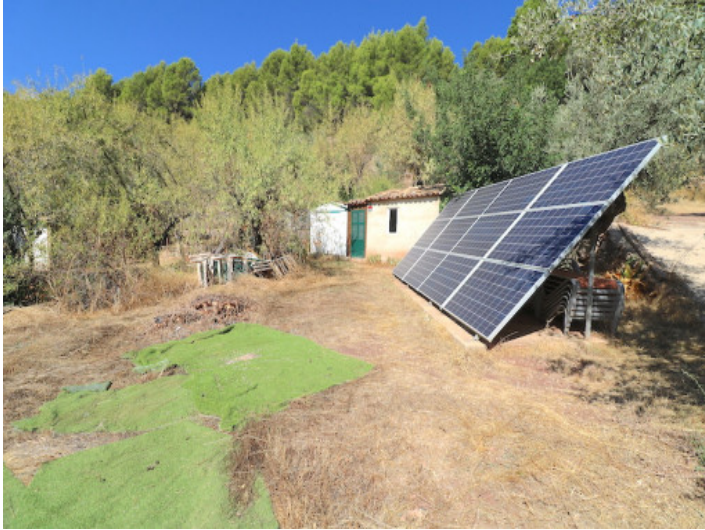
Paneles de solar
